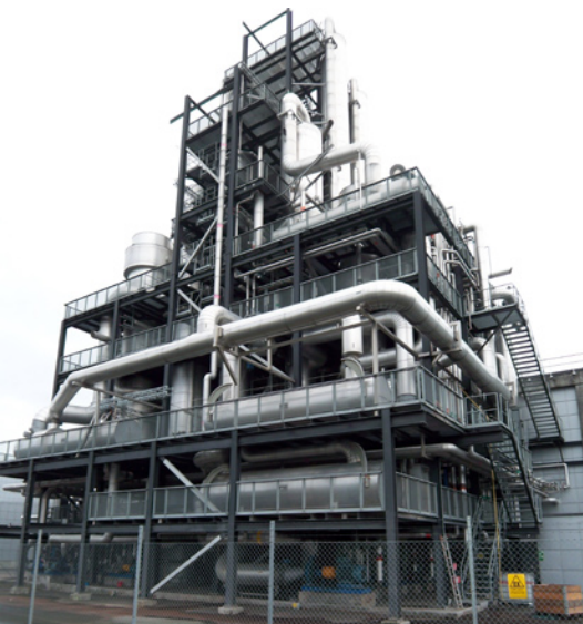
Bild 3: Destillationskolonner. Foto: Jan Fors.
