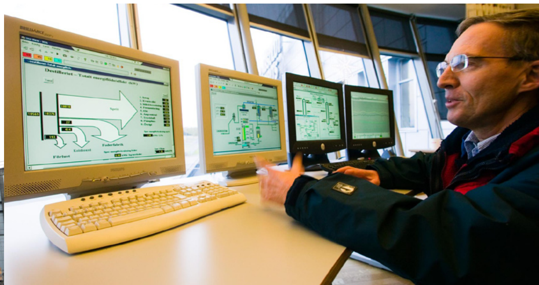
Bild 4: Startbild för energiinformationen i styrsystemet. Startbilden visar momentana värden på energianvändningen inom anläggningen. Foto: Fredrik Persson.
